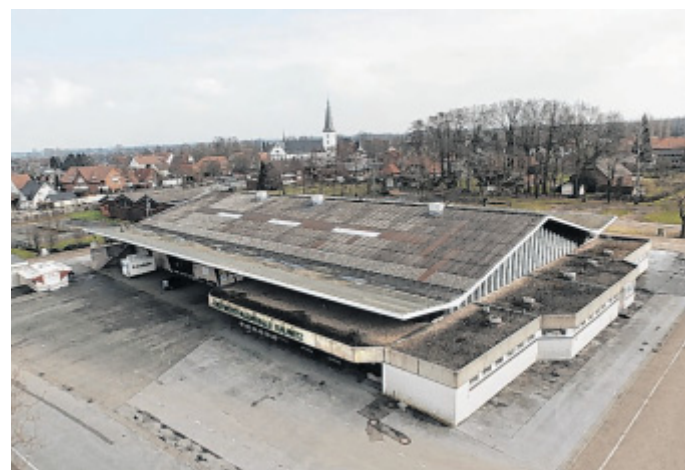
Einsparpotenzial: Bei der Sanierung des Daches der Ostwestfalahalle Kaunitz will die Stadt Geld sparen. FOTO: JENS REDDEKER
